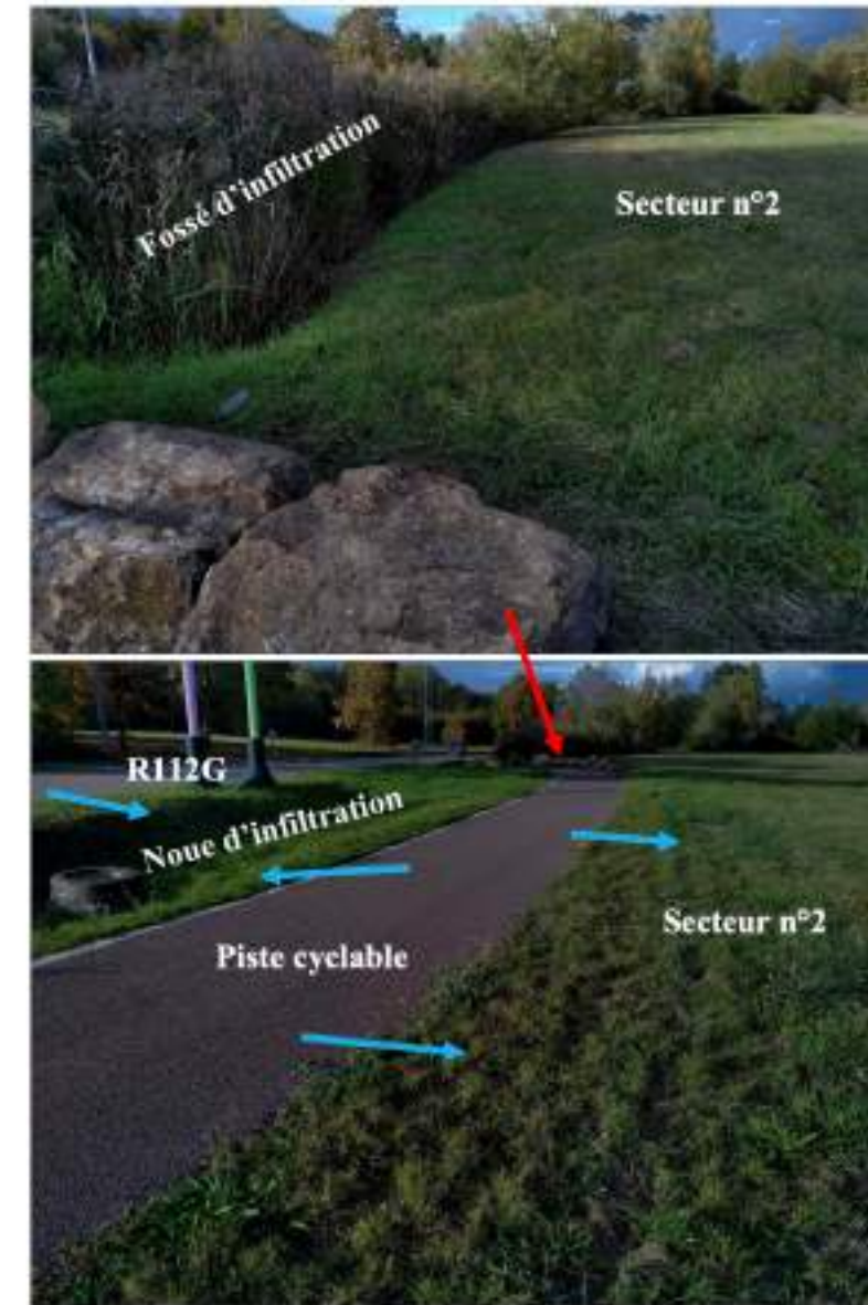
Figure 15 : Illustrations photographiques de la fin du fossé d'infiltration et de la piste cyclable, observés les 13 et 14 octobre 2021
