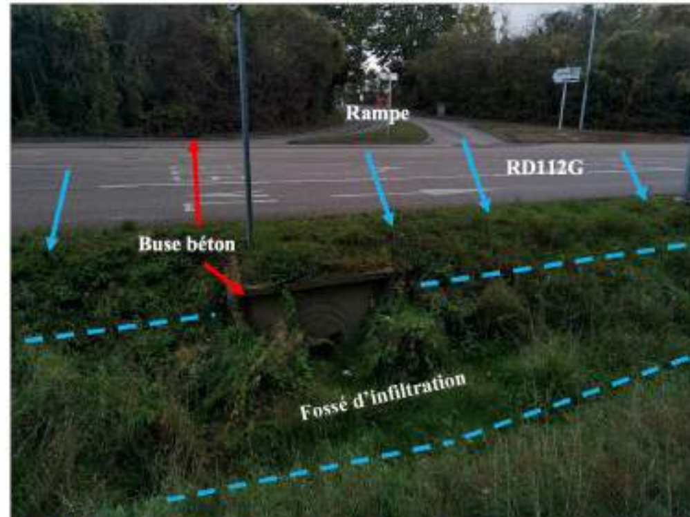
Figure 10 : Illustration photographique de la buse béton dirigeant les eaux pluviales vers le fossé d'infiltration, observée les 13 et 14 octobre 2021
