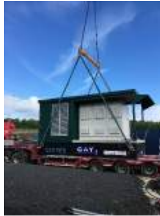
Figure 75 : Livraison d'un poste électrique
