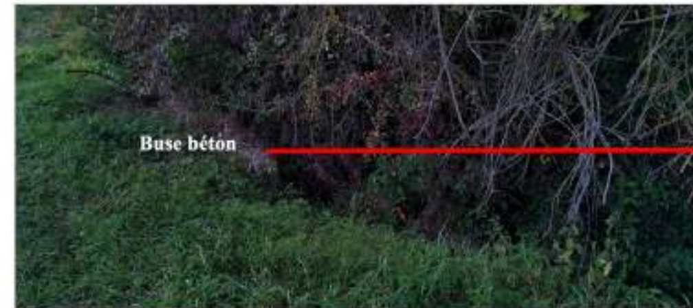
Figure 22 : Illustration photographique de la buse béton dans la dépression, observée les 13 et 14 octobre 2021
